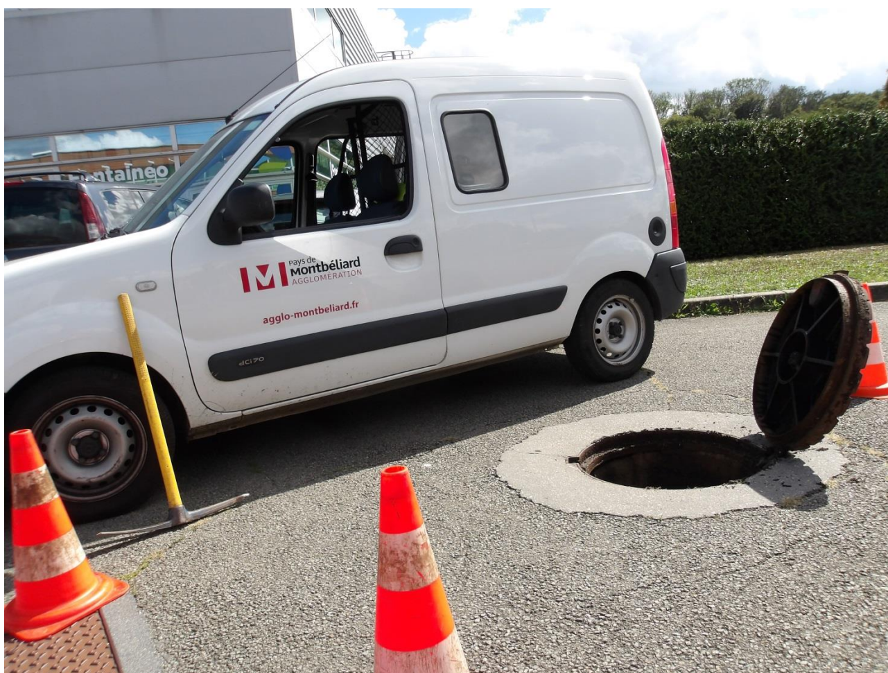
Contrôle branchement à Etupes
